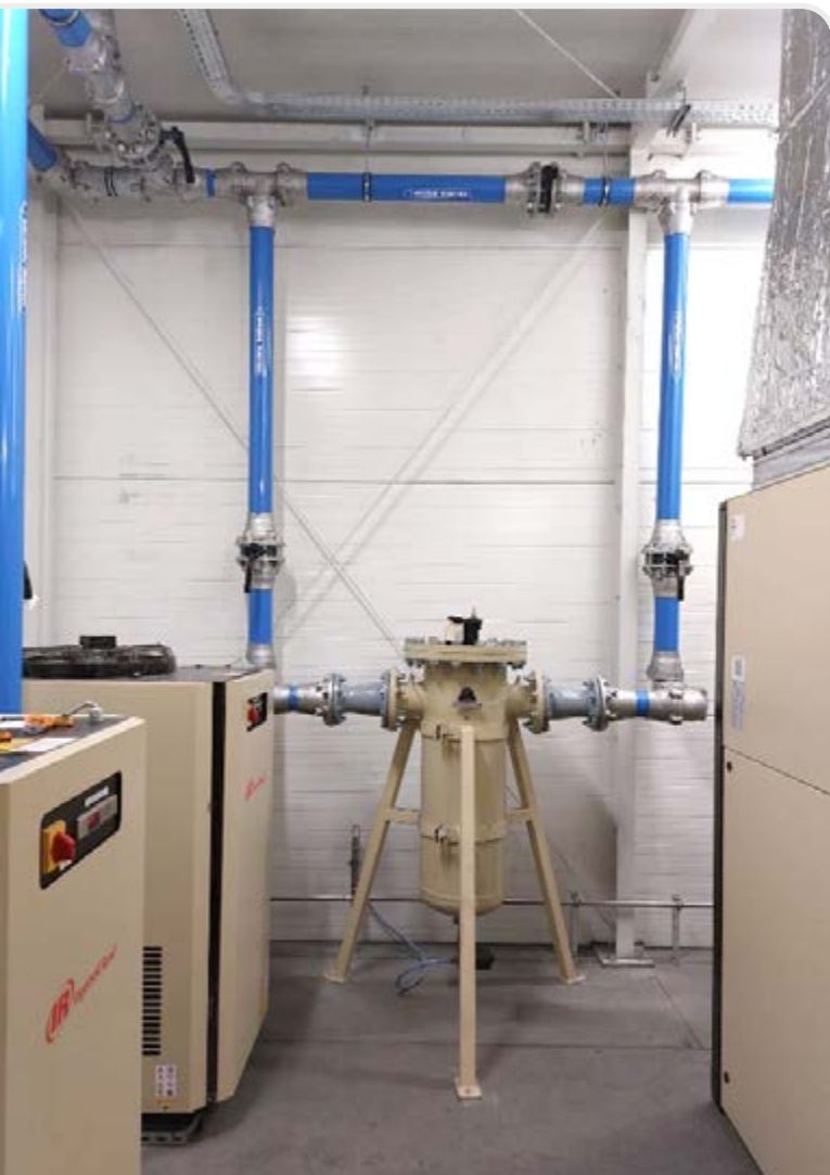
Rys. 6. // Kompleksowa realizacja systemu sprężonego powietrza w zakładzie produkcyjnym Atlas Piotrków Trybunalski, źródło: Ingersoll Rand
